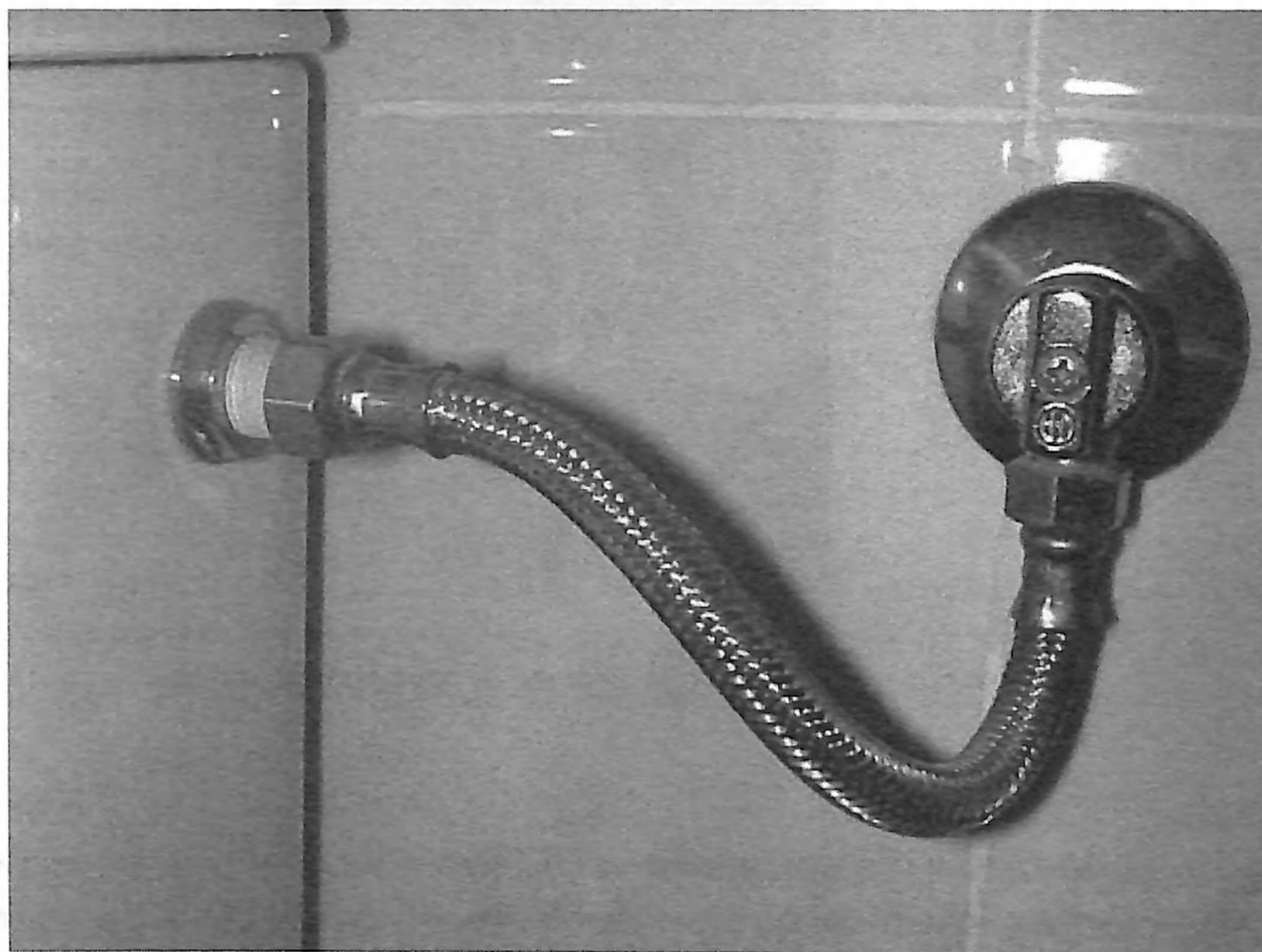
Conexión de agua potable hacia un depósito de un sanitario
