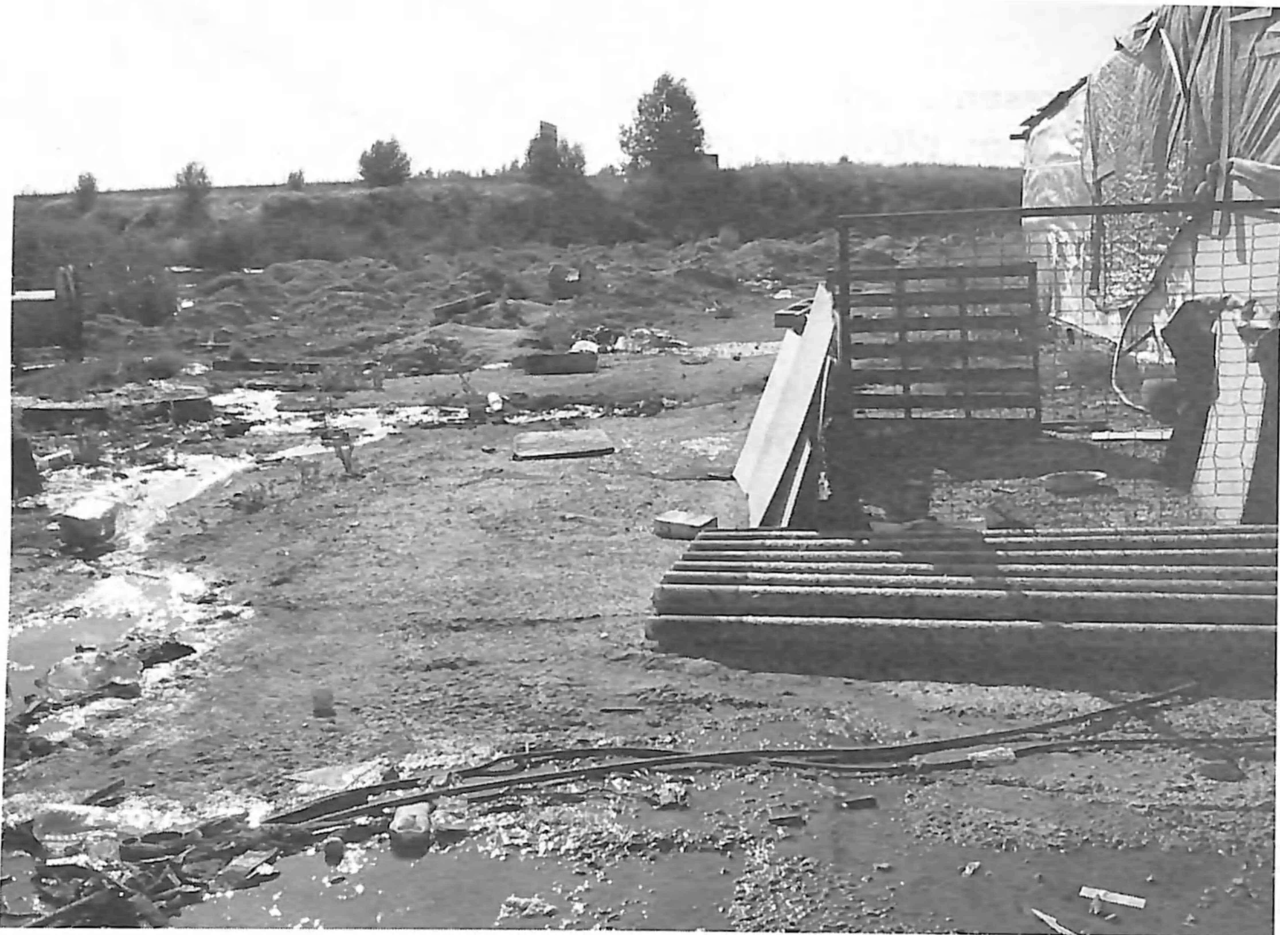
Vertido de aguas negras y pluviales
